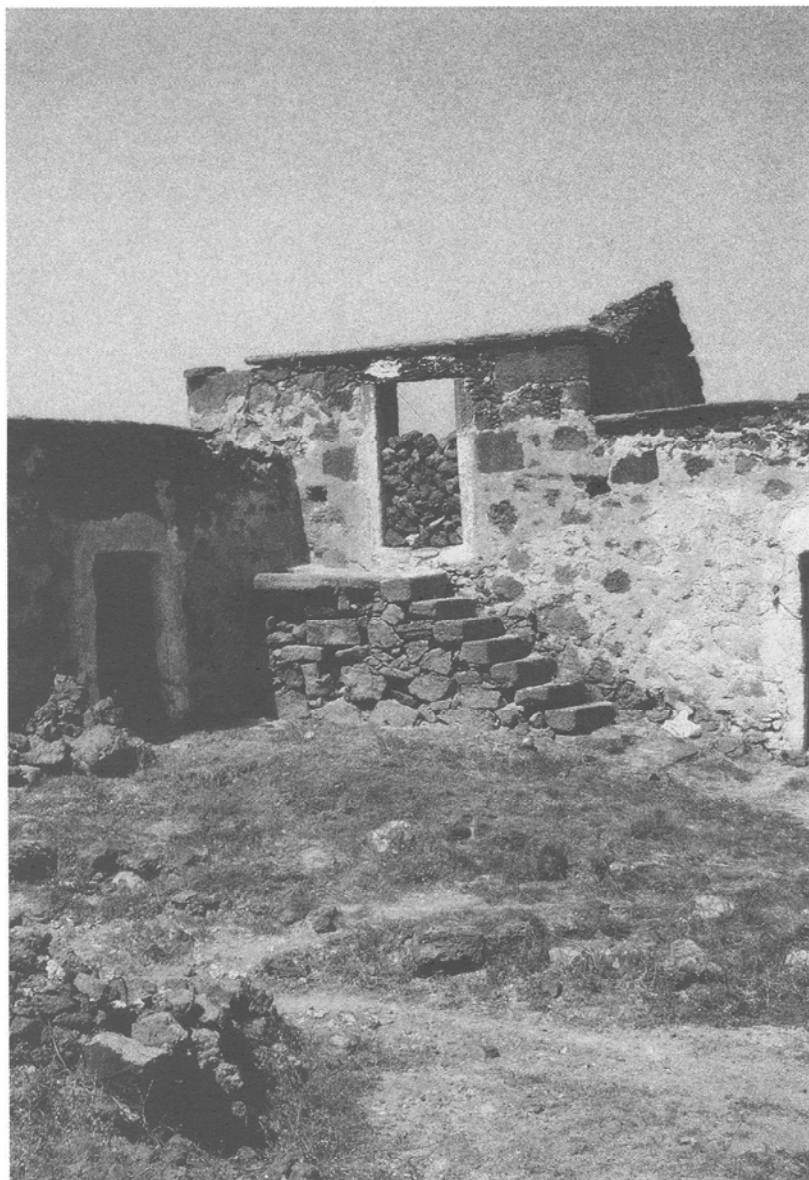
Las Lagunetas (Tinajo). Vivienda en ruinas.
