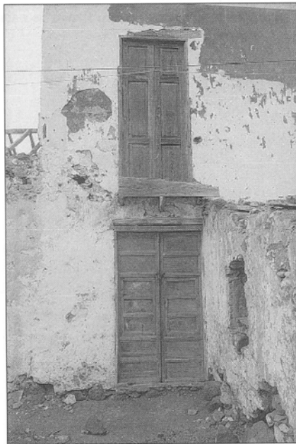
Casa Fuerte. Destalle de la evolución de la carpintería. Puerta de la primera planta estilo siglo XVIII. Puerta dependencia alta, siglo XIX.
