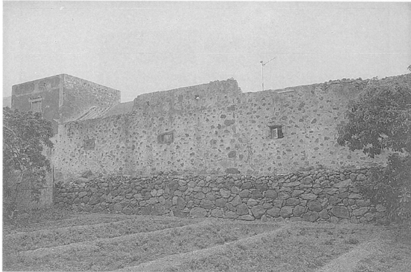
Casa Fuerte. Tapial y cimentación del sector este o flanco de nacimiento, hacia el angosto.
