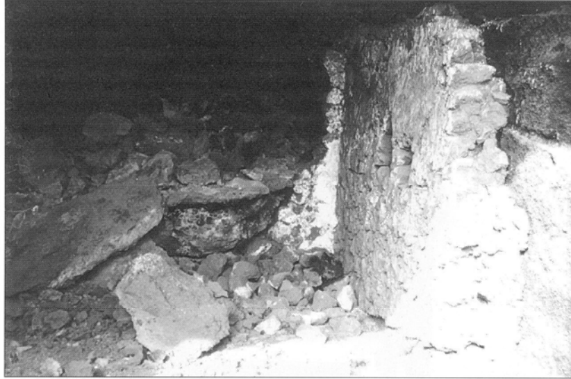
LÁM. 5.—Algunas obras de especial significación histórica no sólo no han sido suficientemente valoradas sino que además no se las ha protegido convenientemente. Cueva de la Pólvora, Valverde (El Hierro).
