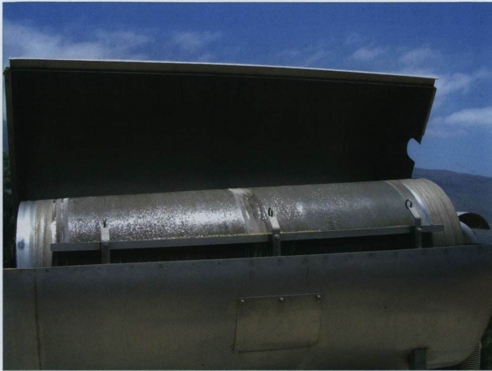
Sistema de separación mecánica (centrífuga)
