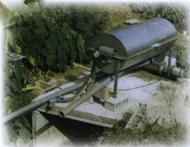
Separador de sólidos
