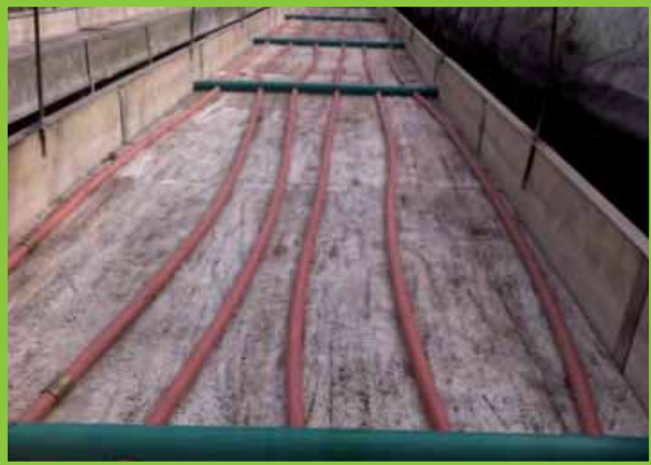
Foto n° 1: Tubería de calefacción en cama de germinación
