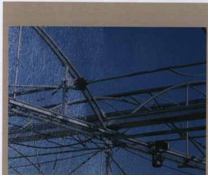
Estructura cenital y mecanismos apertura/cierre ventanas.
