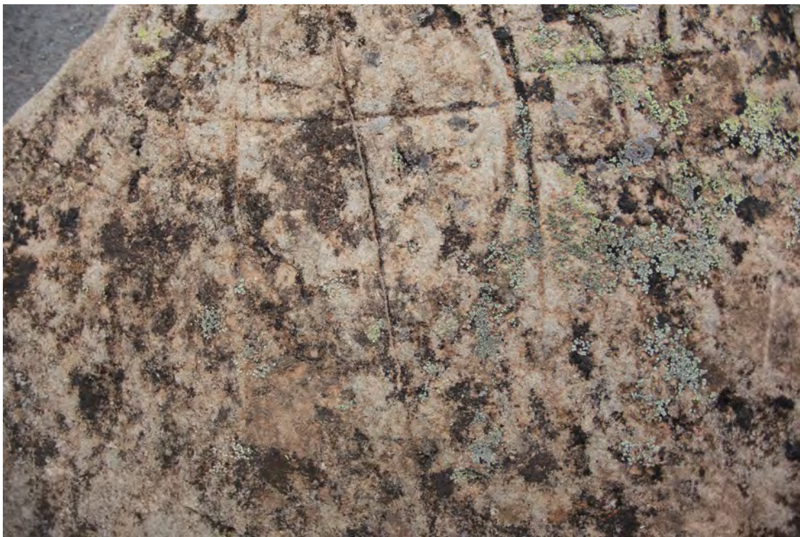
Figura 6. Profusión de líquenes y hongos en panel a barlovento (Los Almácigos, panel 3).
