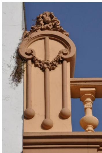
Figura 7. Trilineado en relieve con semiesferas. Edificio de la calle Nava y Grimón nº 37. La Laguna. Foto: el autor.
