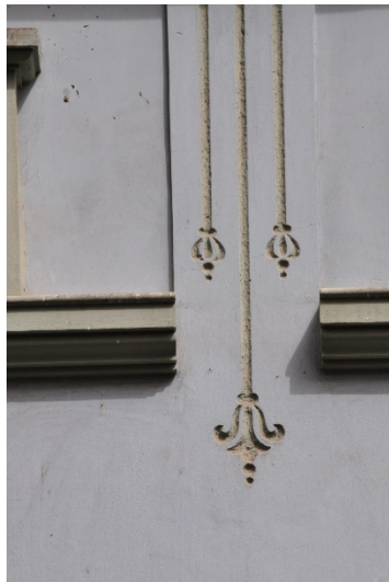
Figura 13. Trilineado esgrafiado. Edificio de la Rambla de pulido nº 56. Santa Cruz de Tenerife Tenerife. Foto: el autor.
